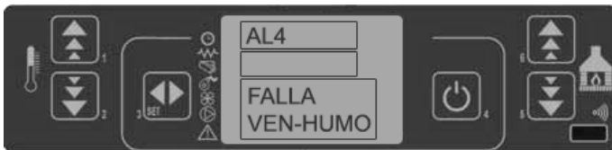
43. panel de mandos - alarma ventilador de aspiración de humos
