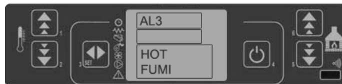
42. pannello comandi - allarme sovra temperatura fumi
