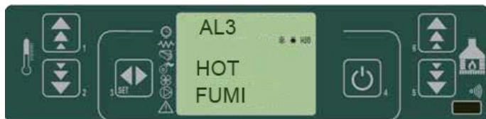
fig. 38 panel de mandos - alarma por exceso de temperatura de los humos
