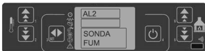
43. pannello comandi - allarme sonda temperatura fumi
