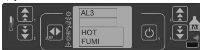
44. pannello comandi - allarme sopra temperatura fumi
