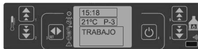
33. panel de mandos - condición de funcionamiento
